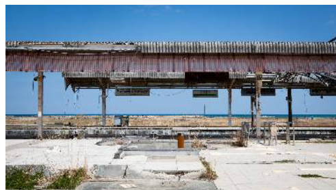
被害を受けたままの富岡駅ホーム
